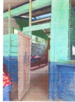
Foto 4: Se observa la necesidad de colocar estructura portante lado oeste (pared) y puerta aula 1
