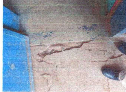
Foto 2: Se observa la necesidad de colocar piso ceramico en el aula No. 2
