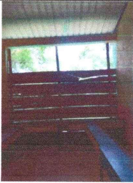
Foto 3: Se observa la necesidad de colocar la estructura portante (pared), lado oeste Aula 1
