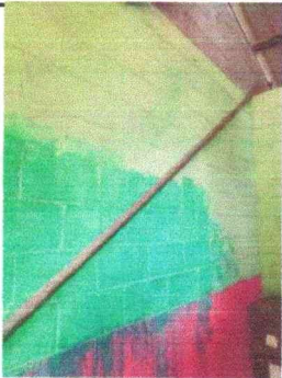
Foto 5: Se observa la necesidad de cernir las paredes para evitar humedad en las aulas
