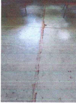
Foto 1: Se observa la necesidad de colocar piso ceramico en el aula No. 1
